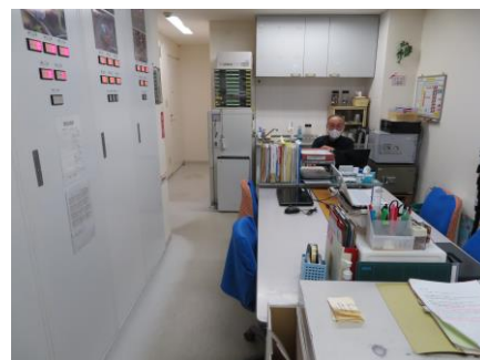
除菌機（1階事務所）の使用風景
